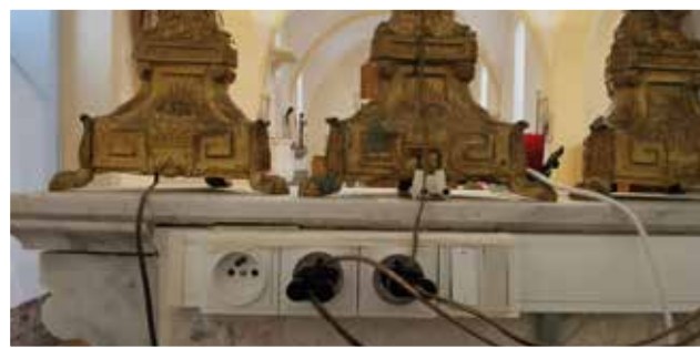
Éviter les installations électriques à risque !
